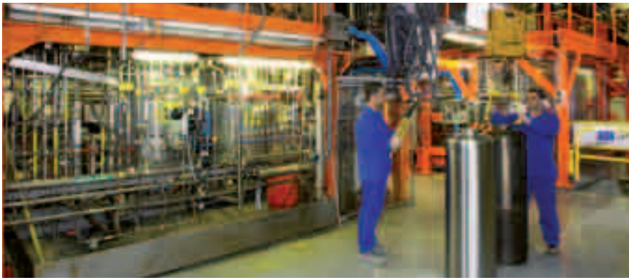
L'installation pilote de creuset froid nucléarisé au centre de Marcoule.
