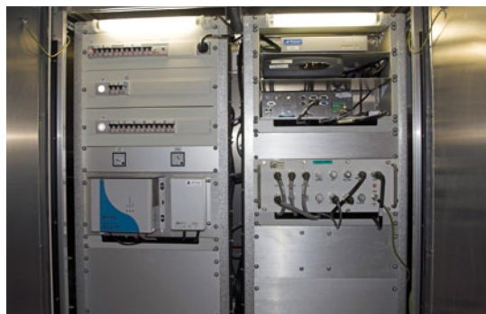
Armoire d'acquisition de données à la station sismique de Pargny-la-Blanche-Côte
