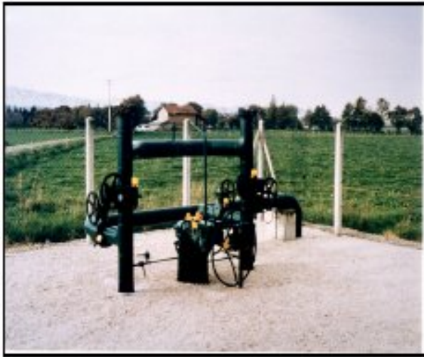
Poste de sectionnement
