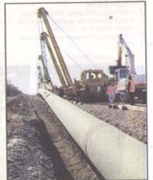
300 km de tuyaux entre Oise et Haute-Marne
