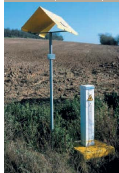
À gauche : balise aérienne À droite : borne de protection cathodique
