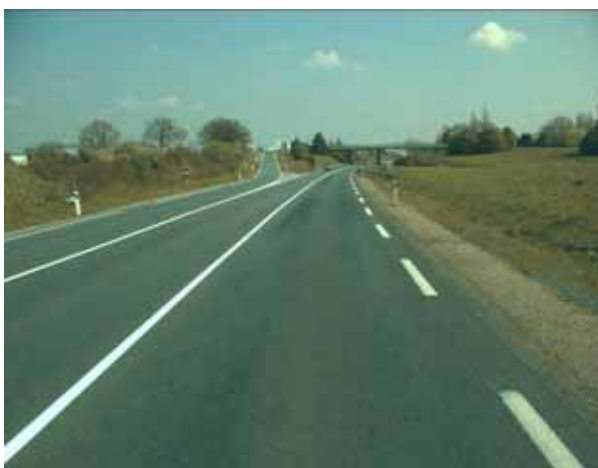
Situation où le conducteur peut mal interpréter la trajectoire qu'il doit suivre – dans ce cas, absence de signalisation verticale pour indiquer le danger.
