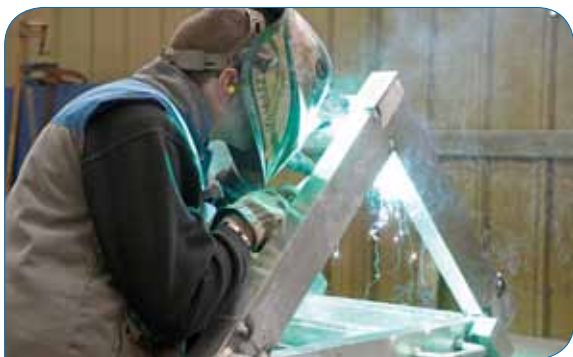
L'entreprise MCM (Ancerville) a participé à la fabrication d'un vireur de rotor pour une centrale nucléaire EDF
