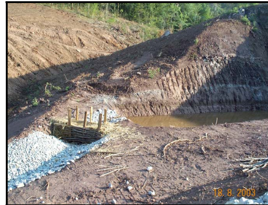
Exemple de bassin de décantation provisoire équipé d'un filtre à paille (chantier A89 – Photo Scetauroute. G. BOURGEOIS, 2003)
