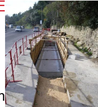
CHAMBRE DE JONCTION
