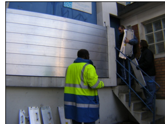
Test de mise en place d'un batardeau sur une station de pompage anti-crue de la DSEA (Val-de-Marne)
