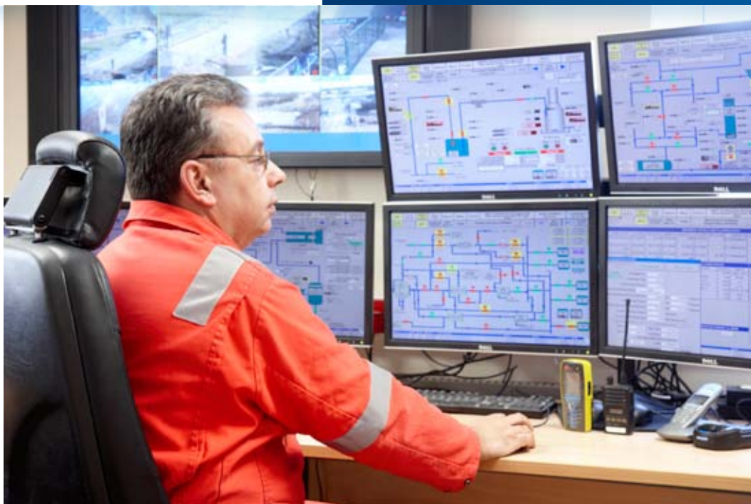
Salle de contrôle du site de Hole House Stockage de gaz EDF Trading, Royaume-Uni
