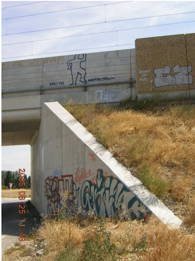
Graphitis sur un ouvrage d'art et murs antibruit.
