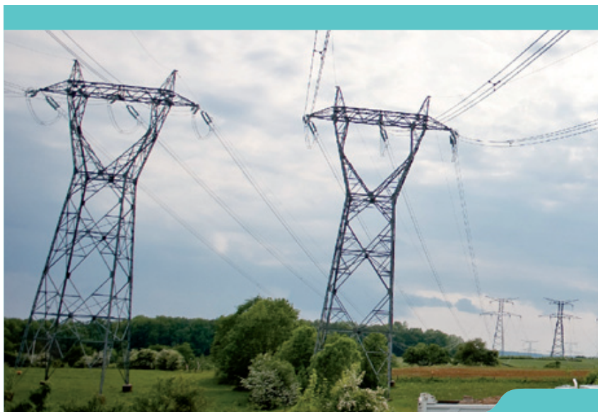
↑ Vue de la ligne 400 kV Lonny-Seuil-Vesle entre Reims et Charleville-Mézières
