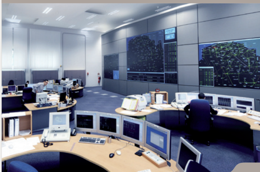
↑ Centre de contrôle de Lomme
