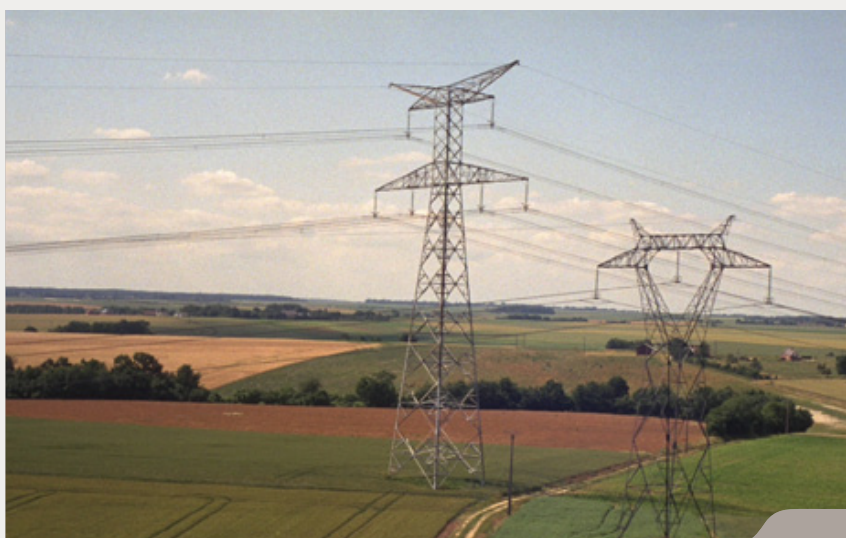
↑ Les pylônes sont adaptés aux tensions et aux capacités transportées
