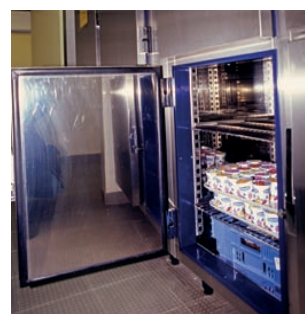
Stockage des produits laitiers dans le réfrigérateur d'un restaurant collectif
