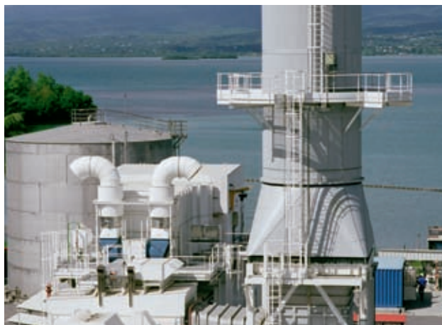
Centrale géothermique de Bouillante (Guadeloupe).
