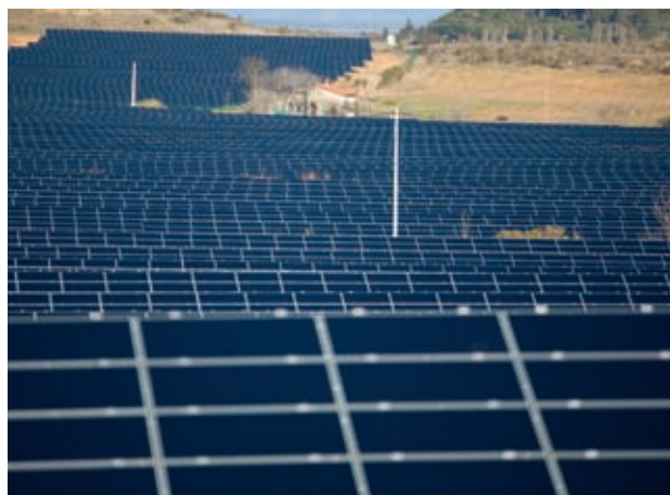
Ferme solaire de Narbonne (Aude).
