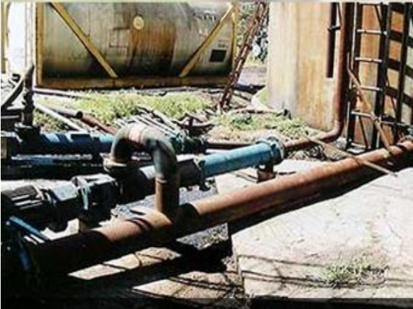
Constructions métalliques - tuyaux
