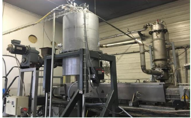
Installation pilote de caractérisation des intrants
