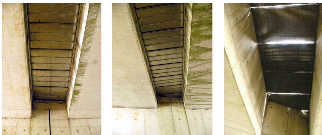
Fermeture des trémies des ouvrages, respectivement de gauche à droite les n°1 à 3. Des défauts de jointure apparaissent pour l'ouvrage du ru de Chauvry.
