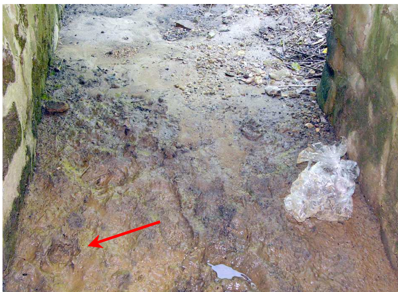
Trace de sanglier (indiquée par la flèche) sortant de l'ouvrage hydraulique au niveau du point bas de la RN1 à la traversée du Bois Carreau, le 18 mai 2005.
