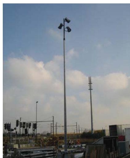
1 : mât d'éclairage du prolongement de l'avenue Dreyfous Ducas
