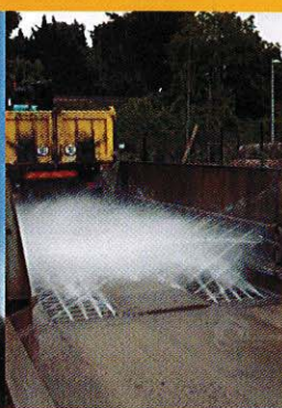
Bac automatique de lavage de roues en sortie de site
