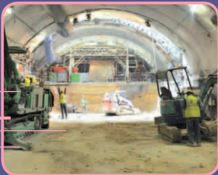
Principal ouvrage du projet, le tunnel serait creusé par un « tunnelier », au rythme de 300 à 350 mètres par mois.
