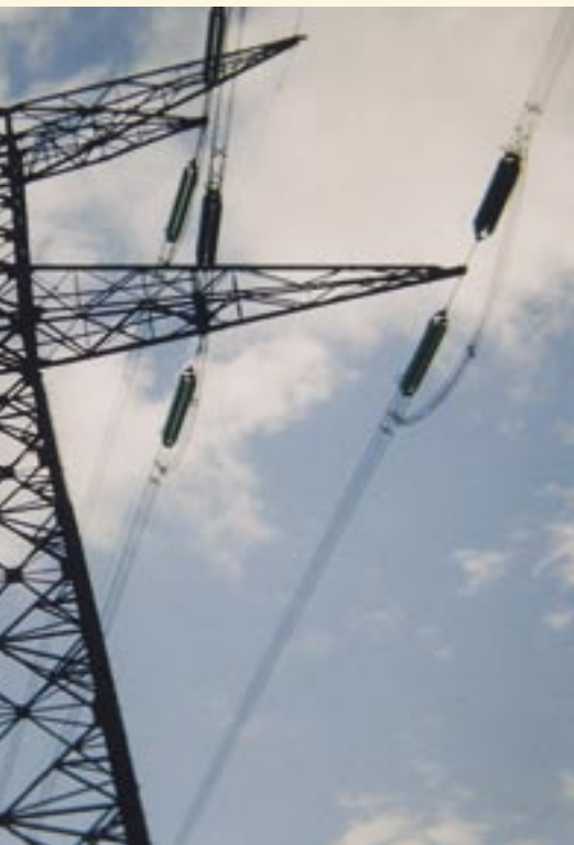
Pylône support de lignes T.H.T. à Flamanville
