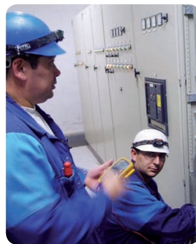
> Intervention sur une armoire électrique
