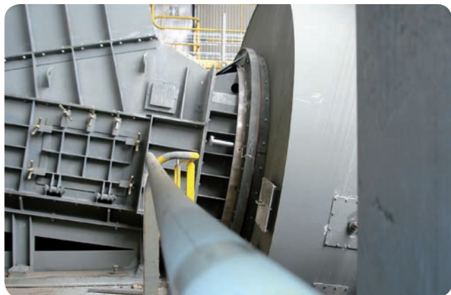
> Four d'incinération des déchets ménagers
